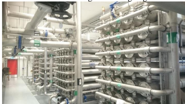
Den nya reningsanläggningen i vattenverket
