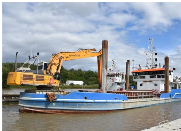
I augusti genomfördes den sista muddringen av banninloppet i Köping. Köpings kommun har därmed slutfört sin del av överenskommelsen med staten att rusta hamnen för att klara dagens och framtidens transporter.
